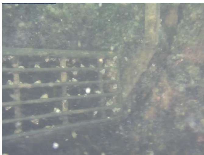
火力発電所 海水取入口 除塵機底回転部
